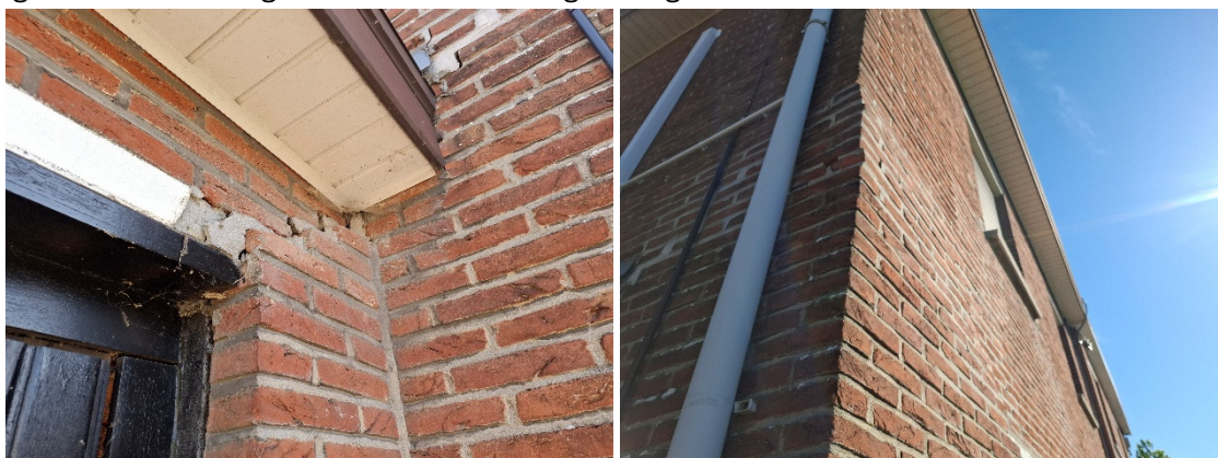
Extra scheurvorming door wegspoelen grond.
