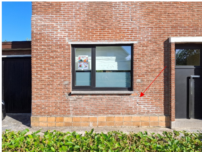
Scheur die opnieuw is open gekomen na herstel.
