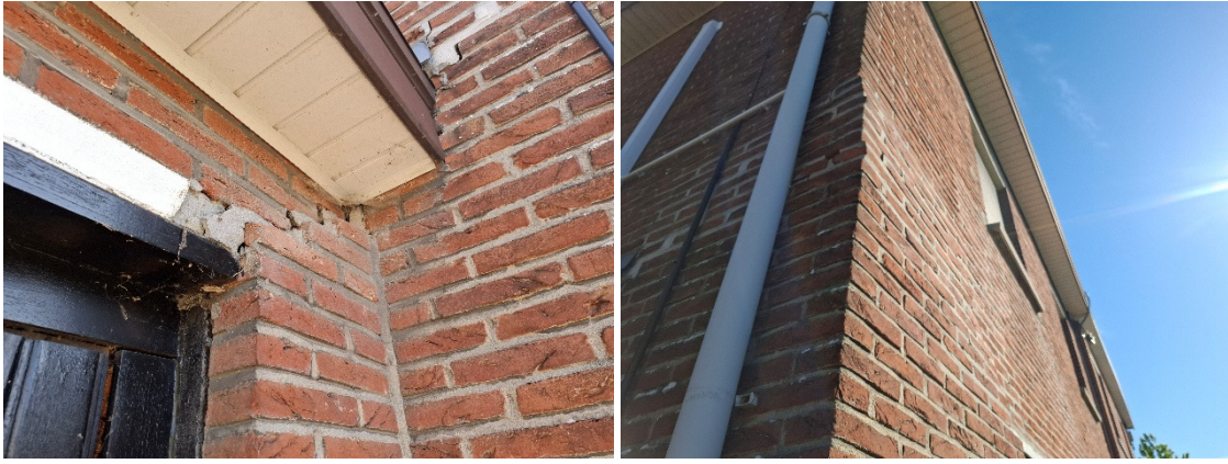
Extra scheurvorming door wegspoelen grond.
